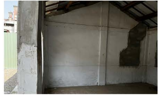
封閉性牆面阻擋了視覺上的通透感 呈現心理上不安定 恐慌
